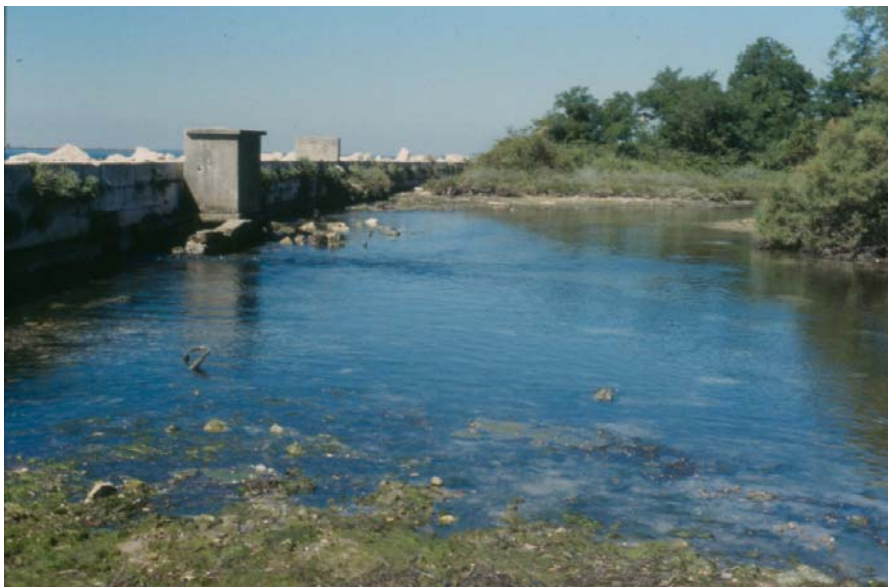
Fig. 3 - Pozze di sifonamento. Area denominata "1" in Fig.1. Zona di depressione a "trincea" prospiciente il fossato dell' ex forte Alberoni.
